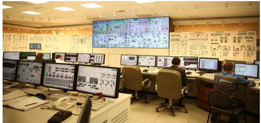
БПУ Энергоблока № 6 Нововоронежской АЭС (2016 г.)
